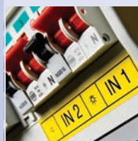
Cajas de distribución y paneles de conexiones
