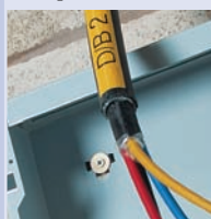
Vías y conductos para cables
